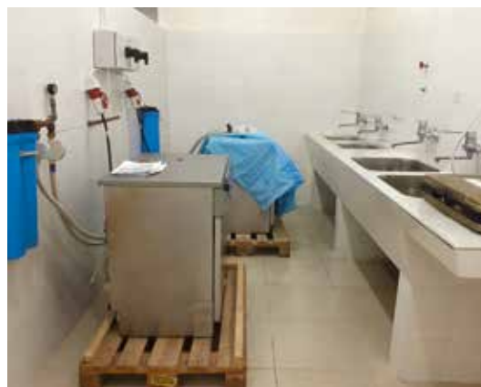
Der umgebaute Aufbereitungsraum der Endoskopie mit den angeschlossenen Spülmaschinen
